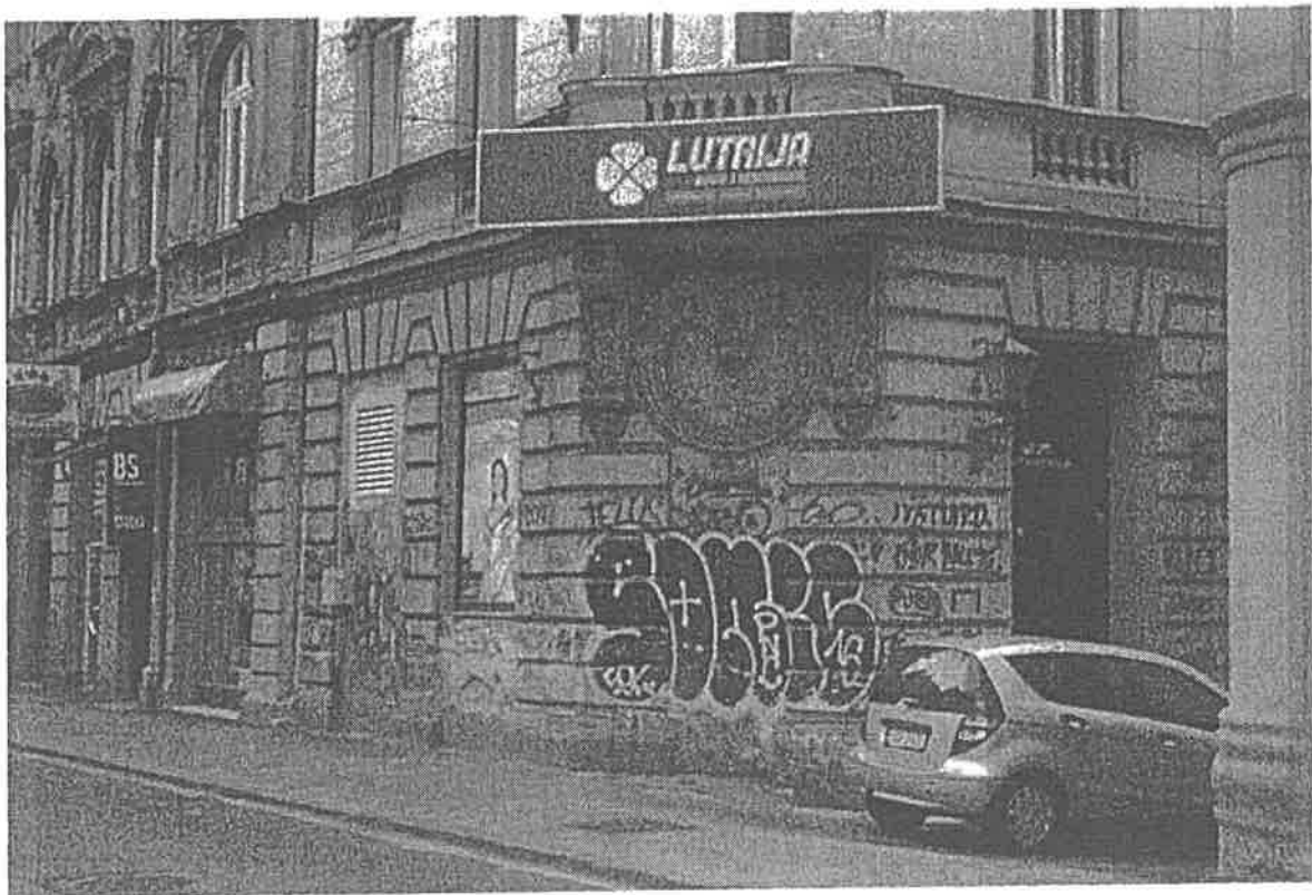
| Objekat sa oštećenim fasadnim platnom
