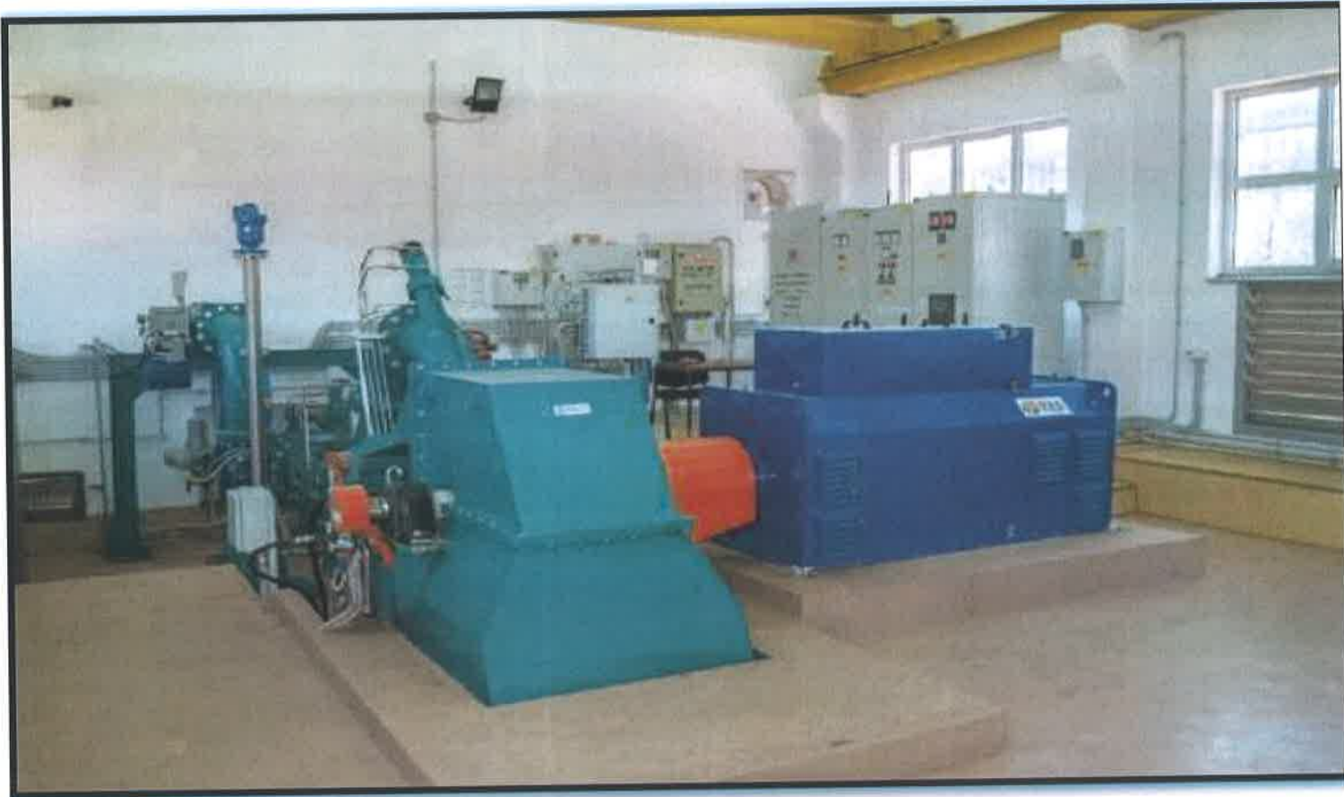
Unutrašnjost mašinske zgrade MHE Čajdraš
