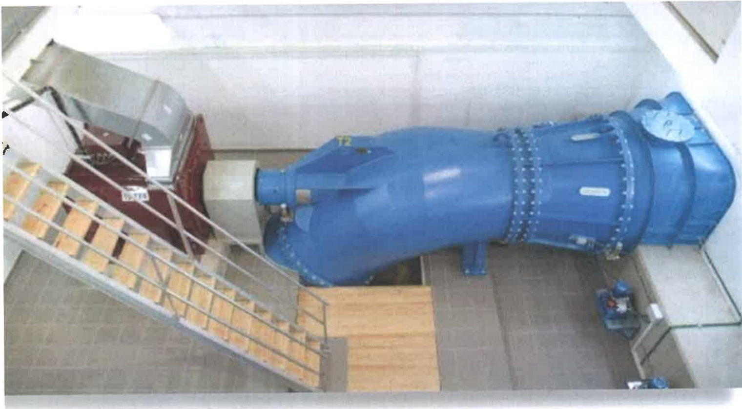
Slika ugrađene kapaln S turbine u postrojenju
