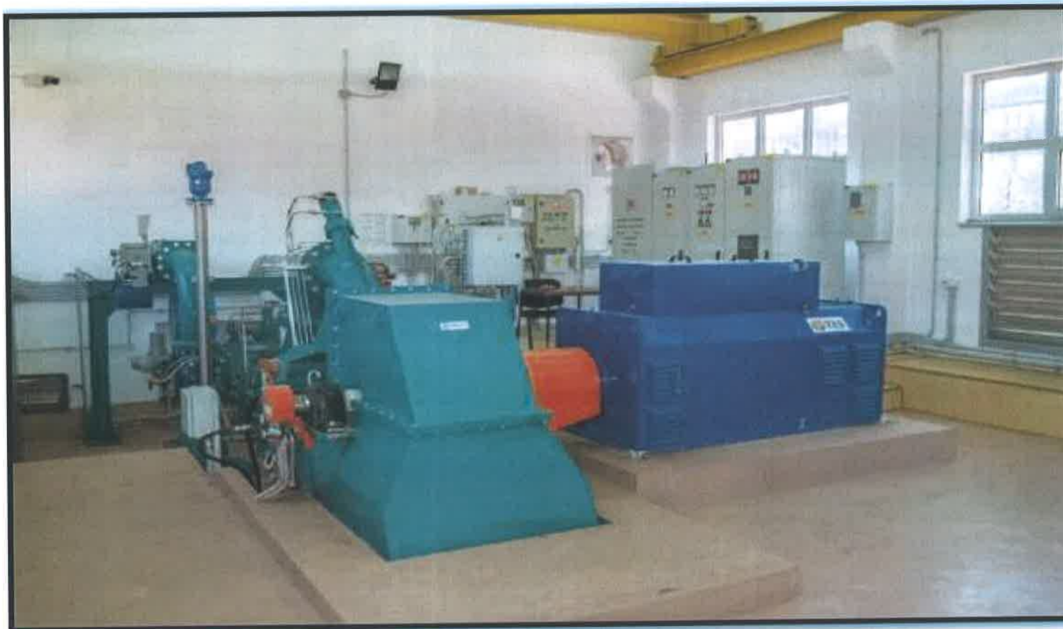
Unutrašnjost mašinske zgrade MHE Čajdraš
