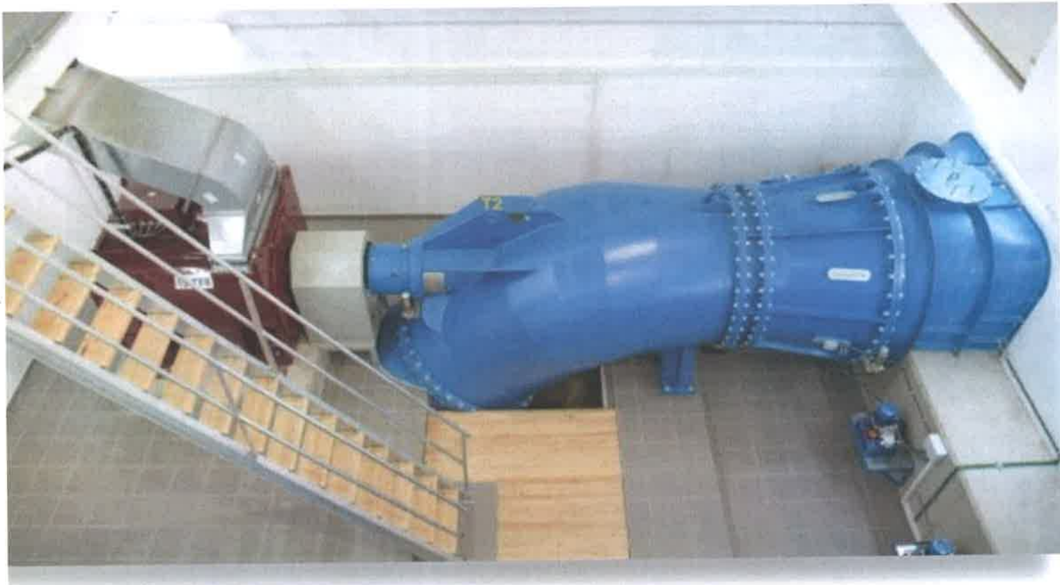
Slika ugrađene kapaln S turbine u postrojenju
